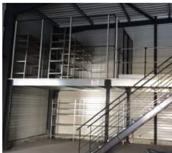
Délimitation du rayonnage Adaptiv XL par de la cloison industrielle, accessible sur une plate-forme Mezzaman Stock.
